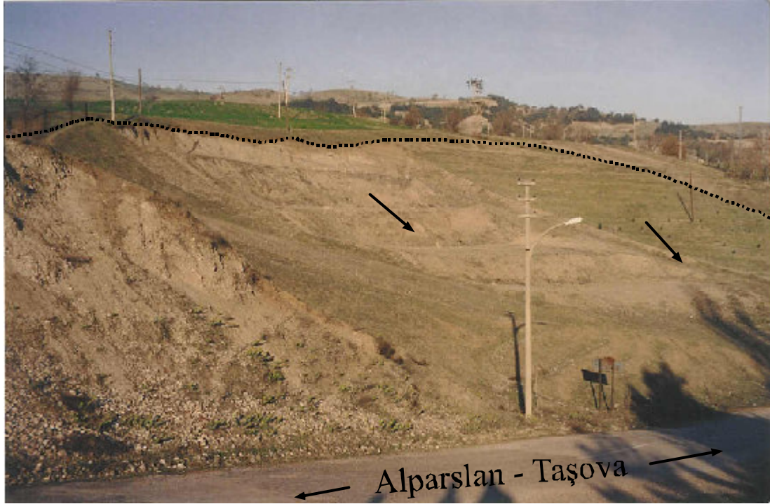
Şekil 11. Taşova-Alparslan yolu üzerinde oluşan VII numaralı heyelan. Heyelan teraslanmış durumda (GB' dan bakış)
