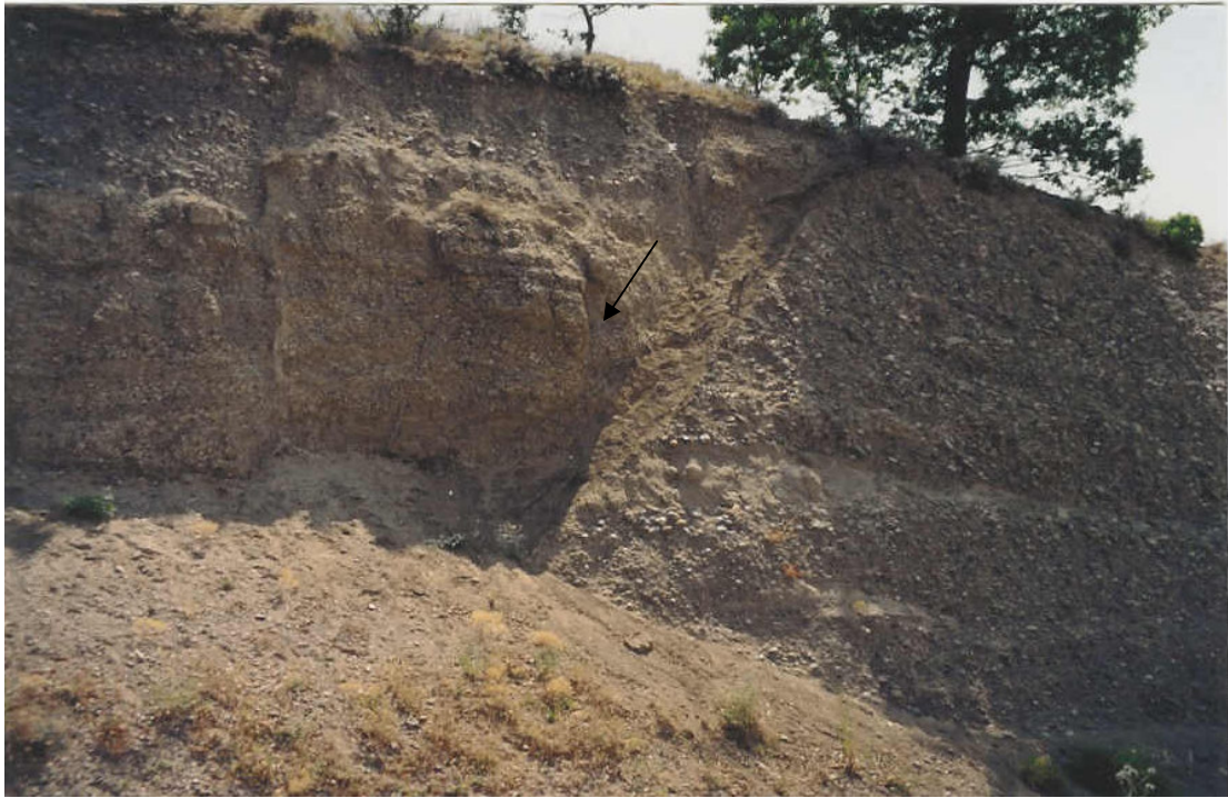
Şekil 5. Taşova – Alpaslan yolu Yulaf çukuru doğusundaki Pliyosen birimlerinde oluşan heyelanın kayma yüzeyinin görünüşü (Batıdan doğuya bakış)
