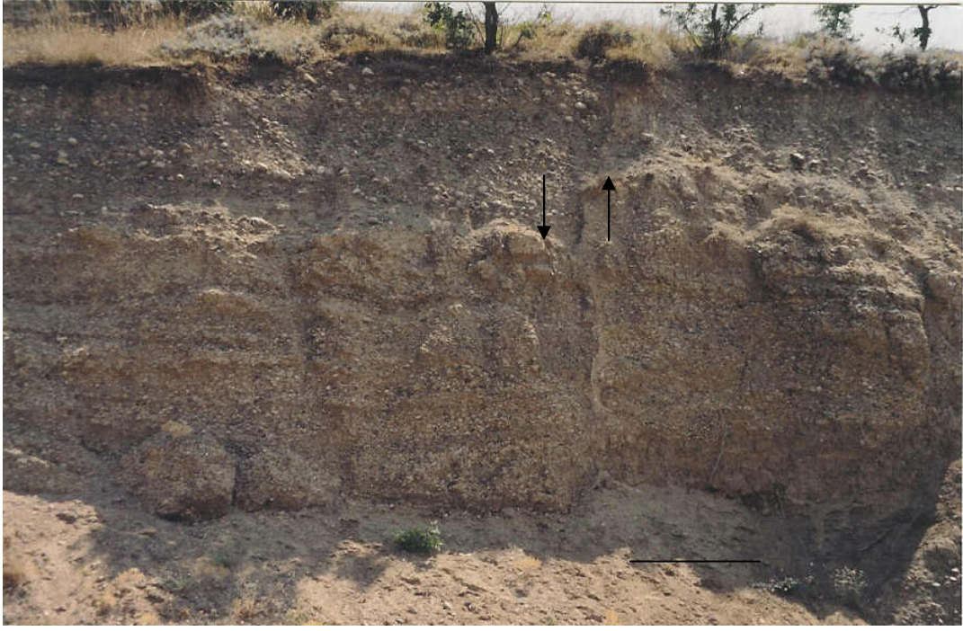
Şekil 4. Taşova – Alpaslan yol yarmasındaki Pliyosen birimlerinde meydana gelen düşey atımlı fay (Atım yaklaşık 30 cm dir).
