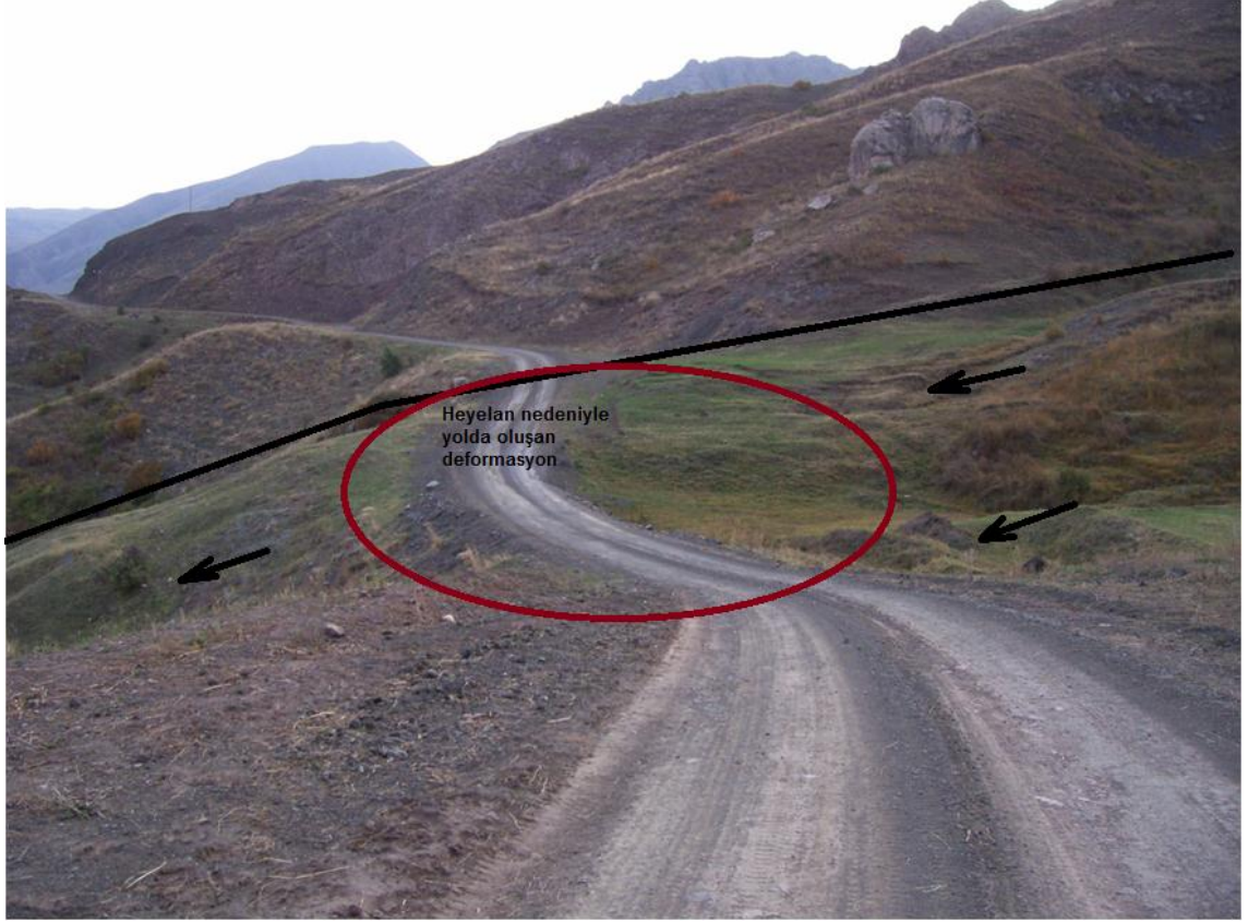
Şekil 5.63 H.4 heyelanının yolda oluşturduğu deformasyon (kuzeyden güneye bakış)
