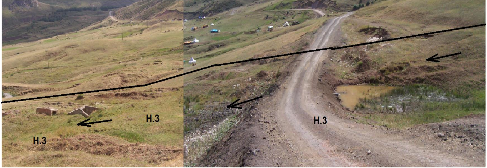
Şekil 5.43 H.3 No.'lu heyelan ile kayan menfezin ve oluşan göllenmenin yol üzerinden görünümü (kuzey doğudan güneybatıya bakış)
