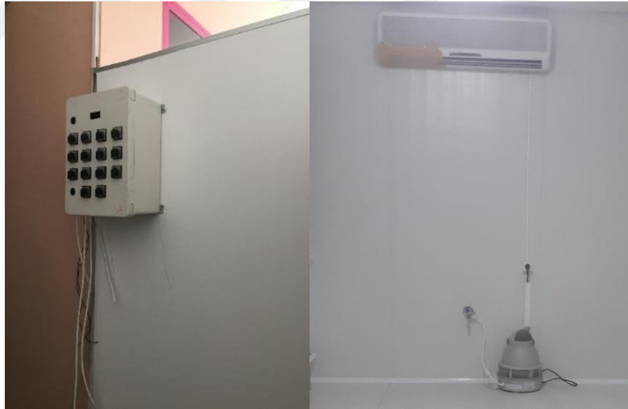
Şekil 3.1 Kontrol ünitesi, klima ve nemlendirme cihazı
