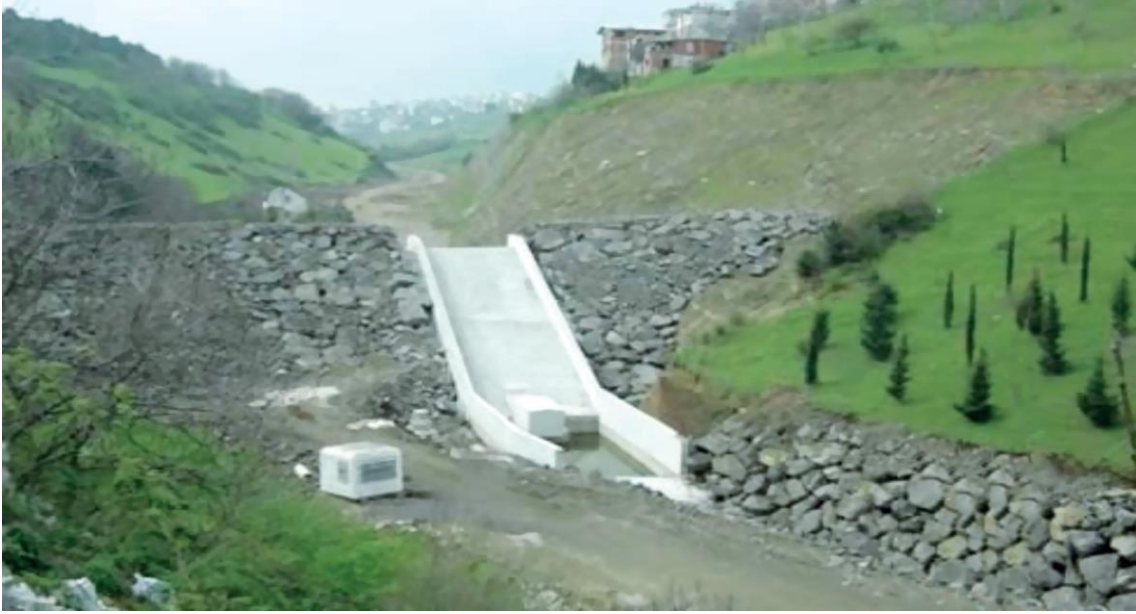
Şekil 15. Taşkın Koruma Amacıyla Samsun'da İnşa Edilen Bir Sel Kapanı (SYGM, 2022)
