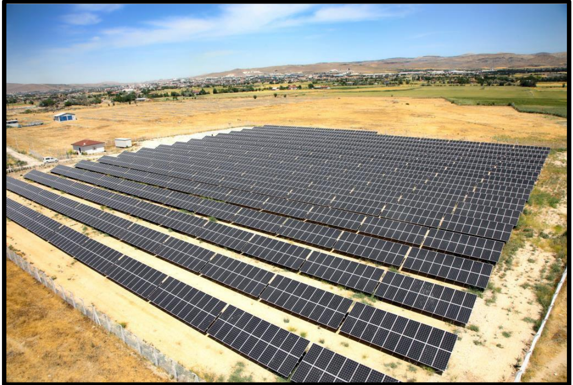
Şekil 4.82 Güneş Enerji Sistemleri (GES) projesi kapsamında kurulan enerji panelleri (Anonim, 2022j)
