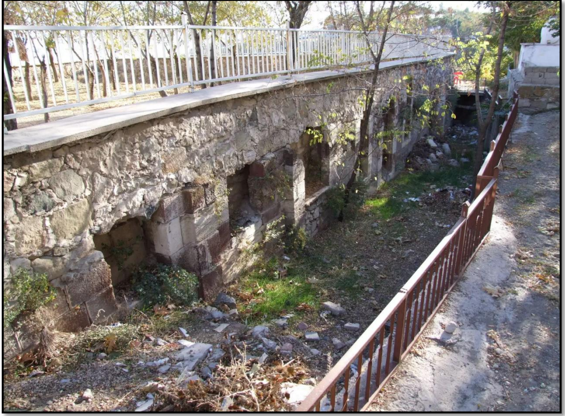
Şekil 4.93 Eski Hükümet Konağı kalıntıları (Anonim, 2021z)
