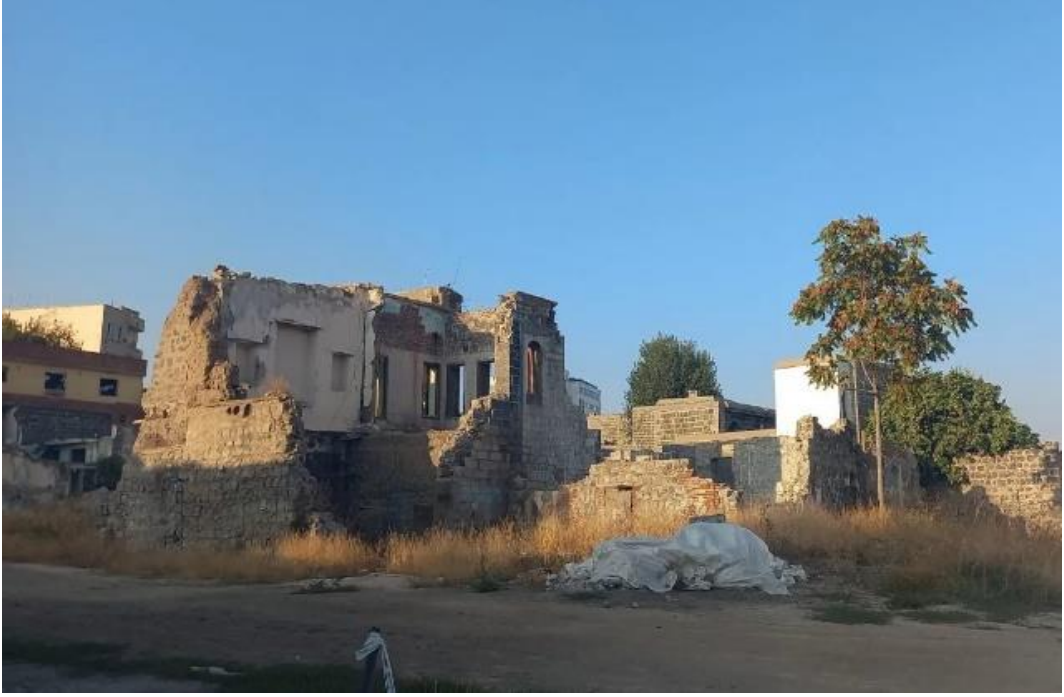
Fotoğraf 3: Suriçi’nde yıkılmış, metruk bir yapı
