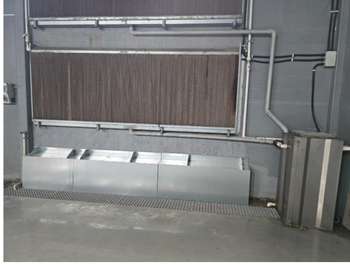
Şekil 3.13 ESS su deposu ve dolaşım hattı
