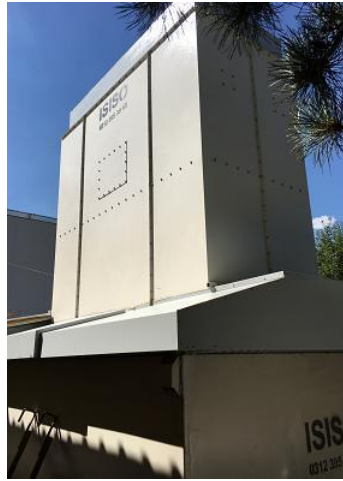
Şekil 3.8 Dinamometre soğutma suyu kulesi
