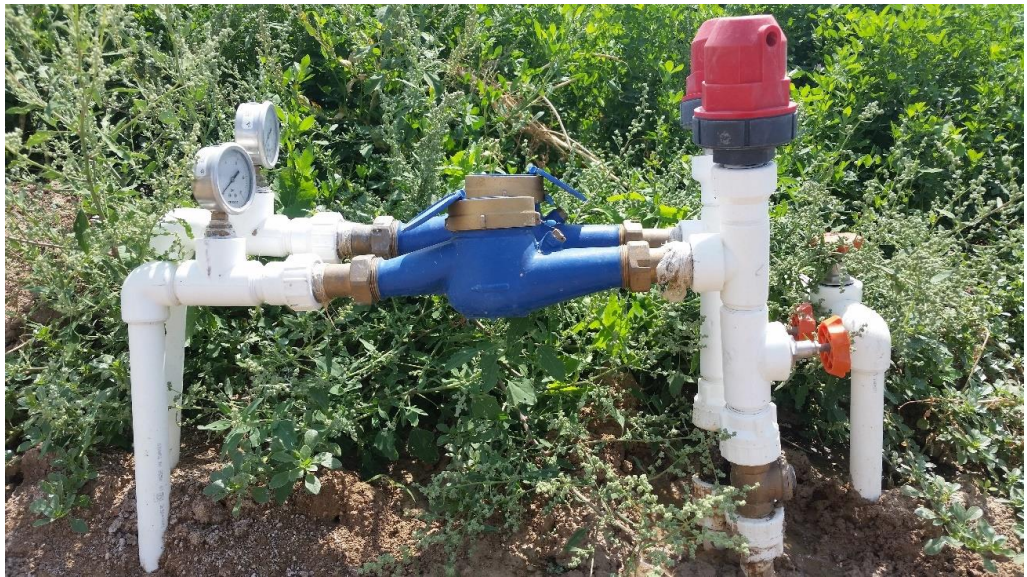
řekil 3.6 Hat bařlarında kullanılan su sayacı, manometre ve vantuz
