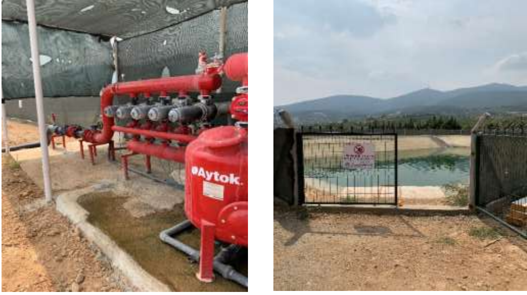
Şekil 5.4 Kontrol ünitesi ve sulama havuzu
