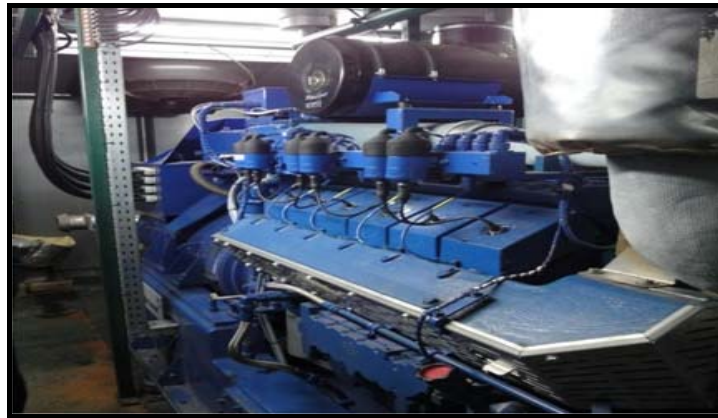
Şekil 2.43 Biyogaz tesislerinde kullanılan Gaz-Otto Motor
