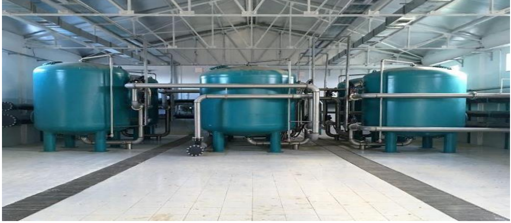
Şekil 3.26 Basınçlı Filtre Tank Sistemi
