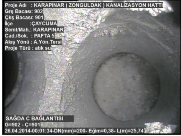
Şekil 3.16 Kanalizasyon Kamera Görüntüsü
