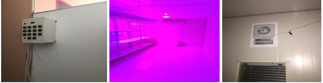
Şekil 3.6 Kontrol ünitesi, klima, nemlendirme cihazı ve fan
