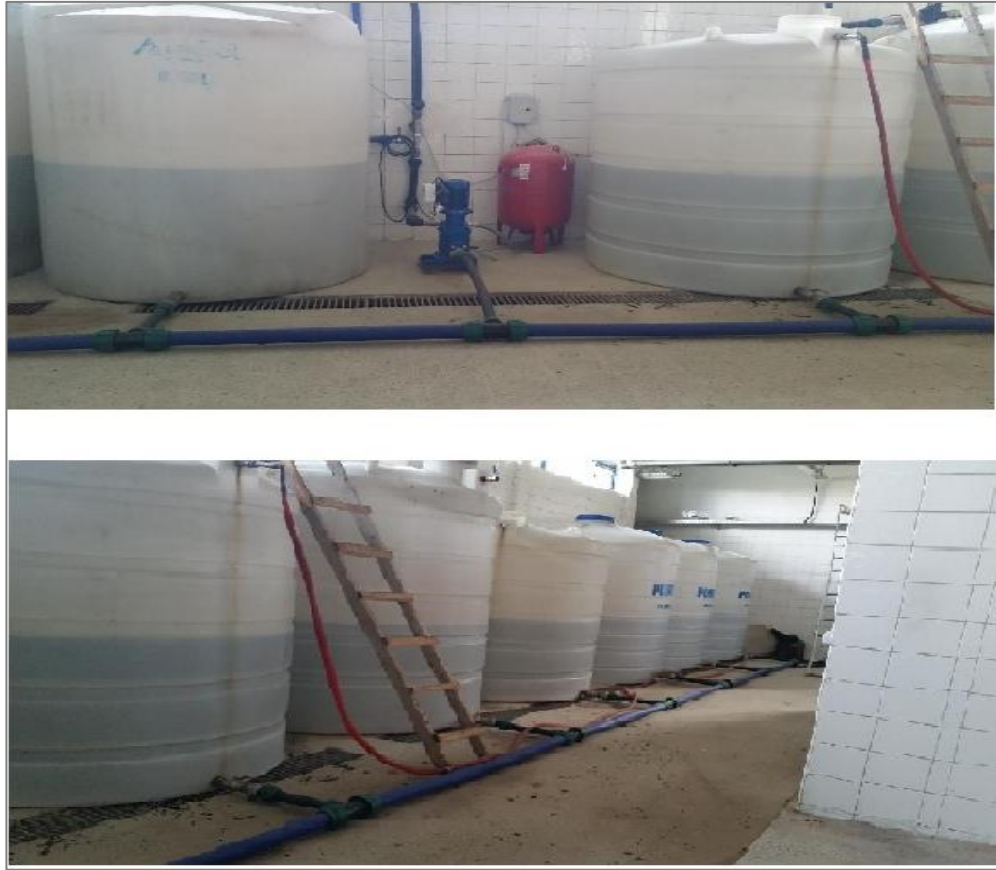
Şekil 5.3 Yağmur Suyu Depolama Alanı
