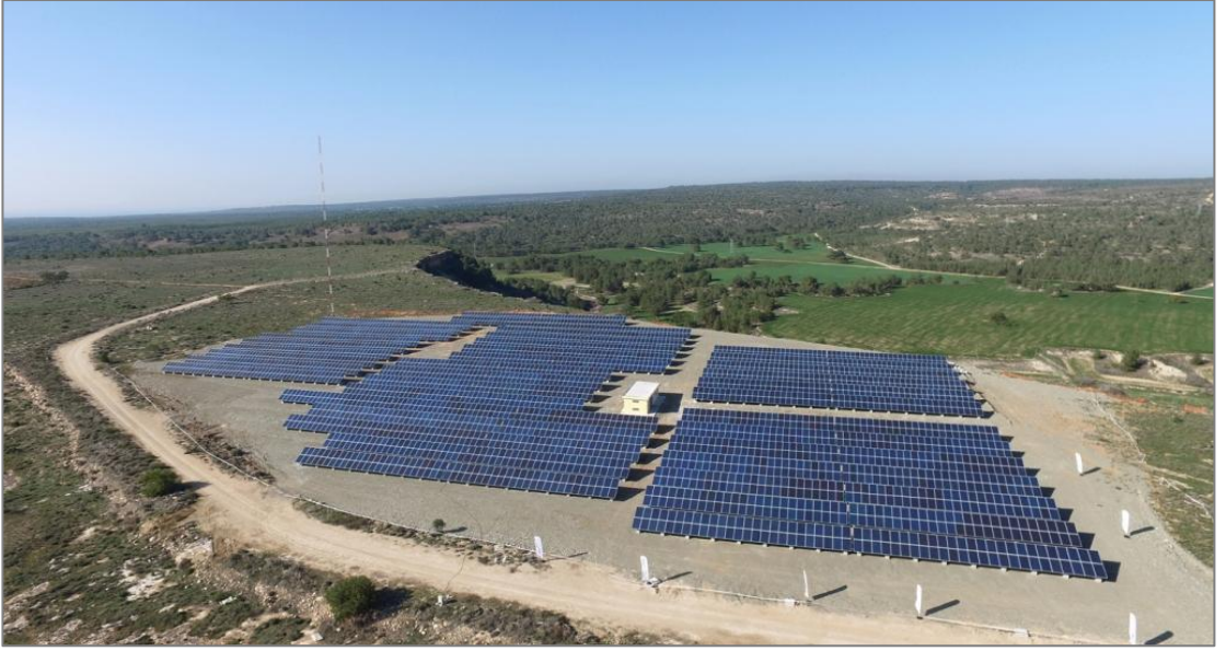
Şekil 4.13 ODTÜ Fotovoltaik Panelleri
