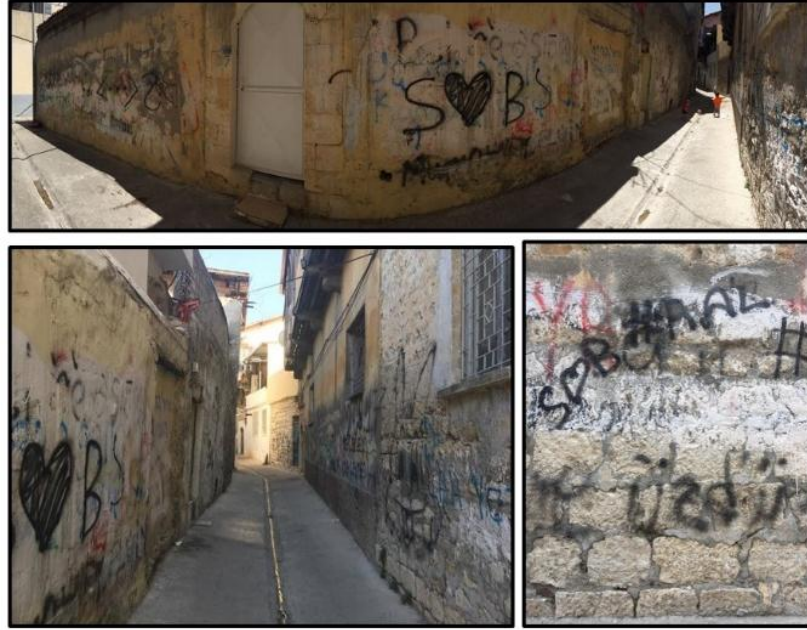
Şekil 4.47 Gazipaşa Caddesi'ndeki yapıların cephelerinde bulunan duvar yazıları (Orijinal 2017-2018)
