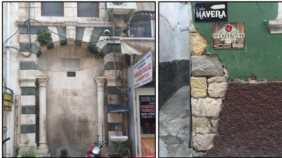
Şekil 4.49 Tescilli binaların cephelerindeki yapısal değişimler (Orijinal 2018)
