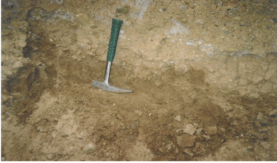
Şekil 6.7 Olası kayma yüzeyinin yakından görünüşü
